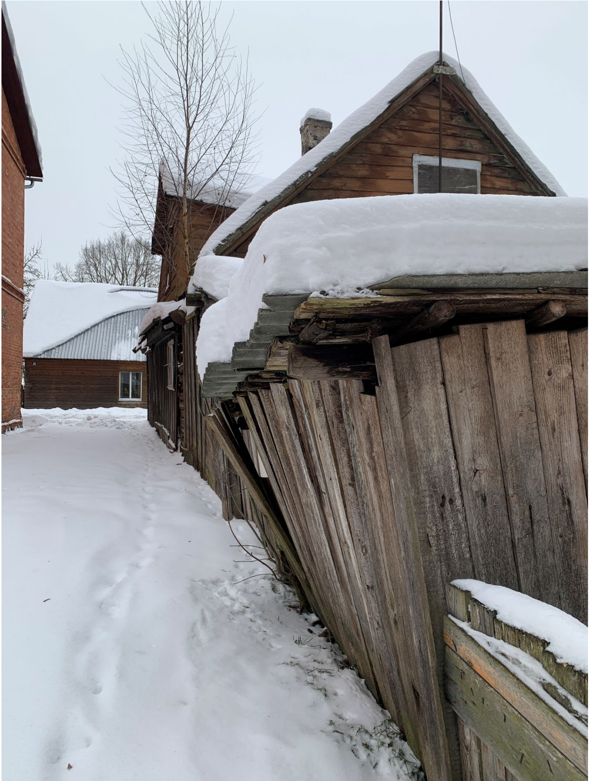
Foto 2. Uus tn 16//18 vana elamu ja kuur Uus tn 14 kinnistult vaadatuna. Kuuri katus sisse vajunud ja seinad tugevalt Uus tn 14 kinnistu poole kaldu.
