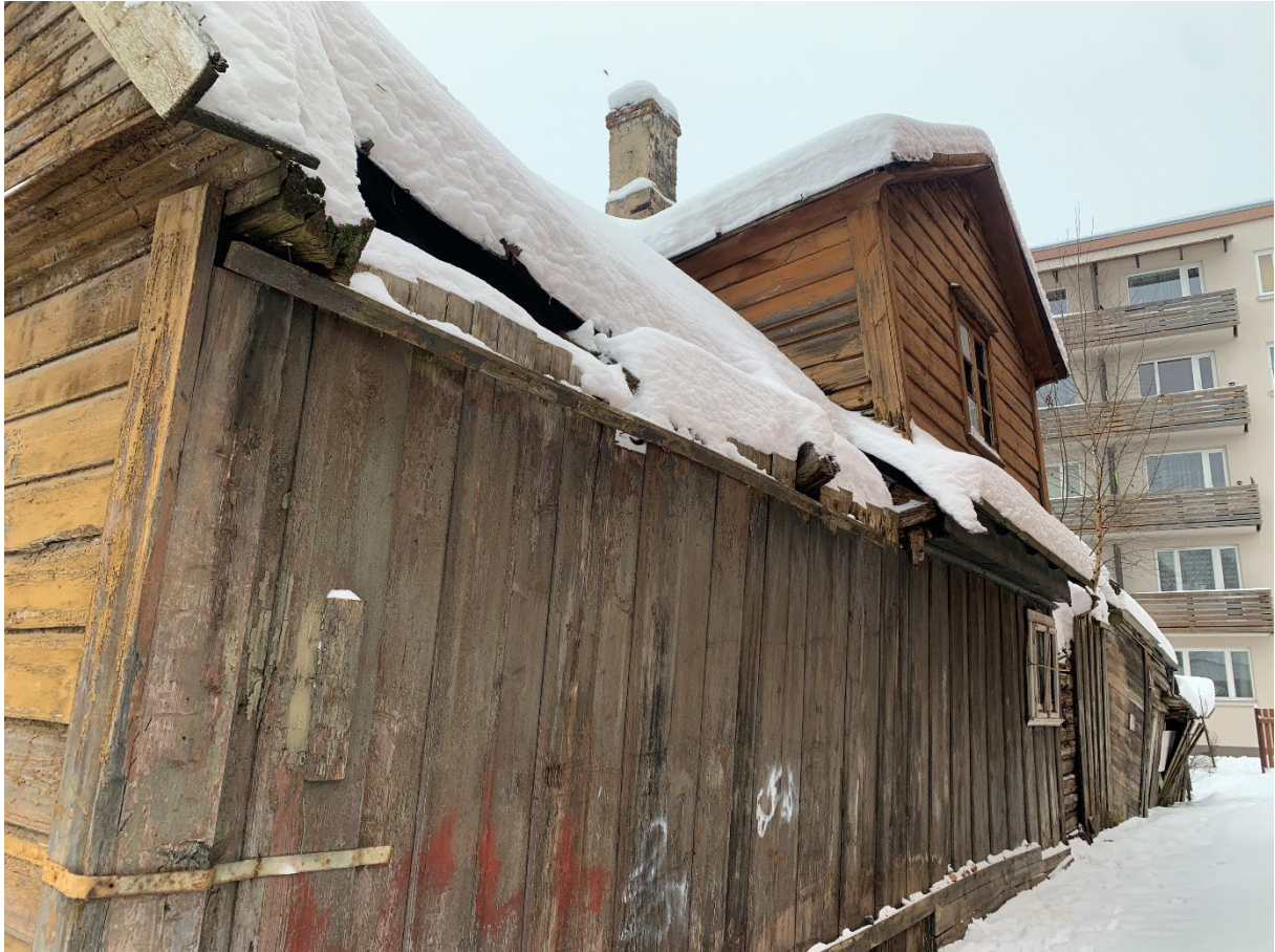
Foto 5. Uus tn 16//18 vana ja lagunenu elamu Uuelt tänavalt vaadatuna. Hoone vajunud viltu Uue tn 14 kinnistu poole.
