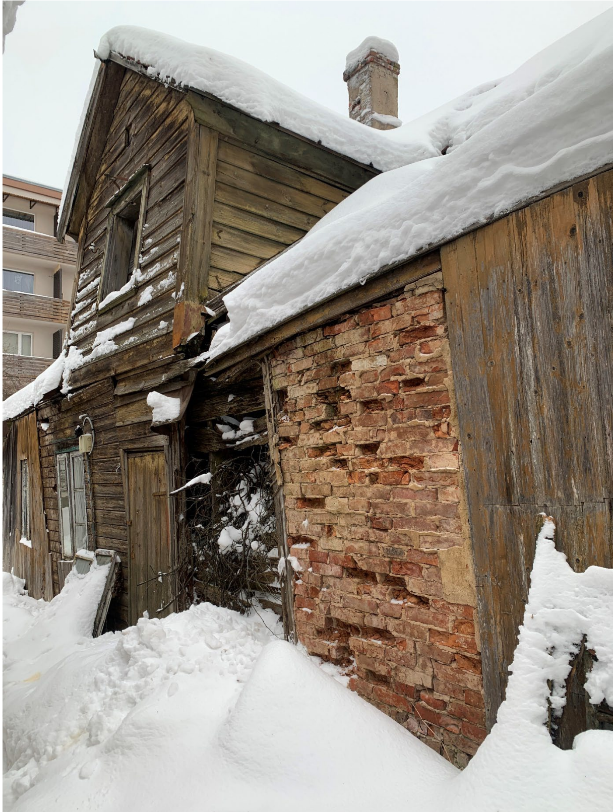
Foto 6. Uus tn 16//18 vana ja lagunenu elamu uue tänavalt vaadatuna, vasakule jääb Uus tn 16//18 elamu. Hoone vintskap on tugevalt viltu vajunud, seinad lagunenu ja osaliselt puudu.
