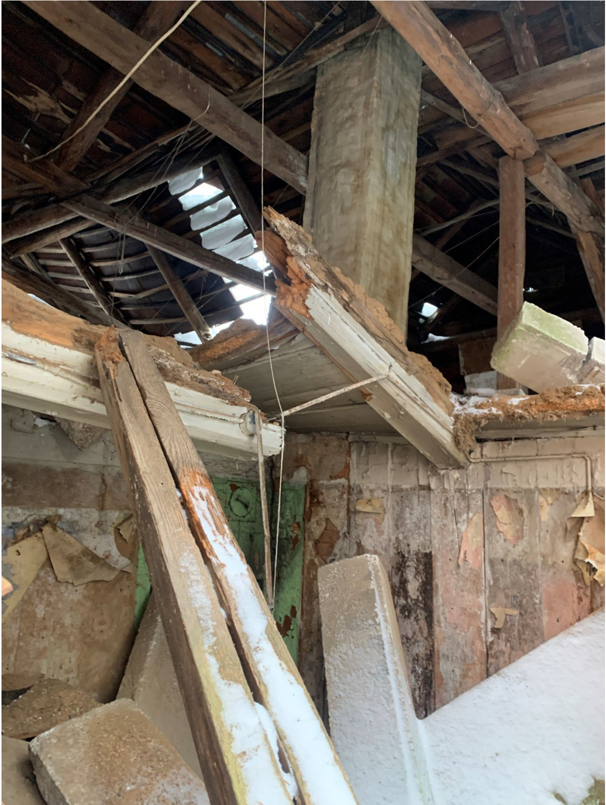
Foto 4. Uus tn 16//18 vana ja lagunenu elamu seest. Vahelagi sisse kukkunud, katuse konstruktsioonid mädanenud ning sisse vajunud.
