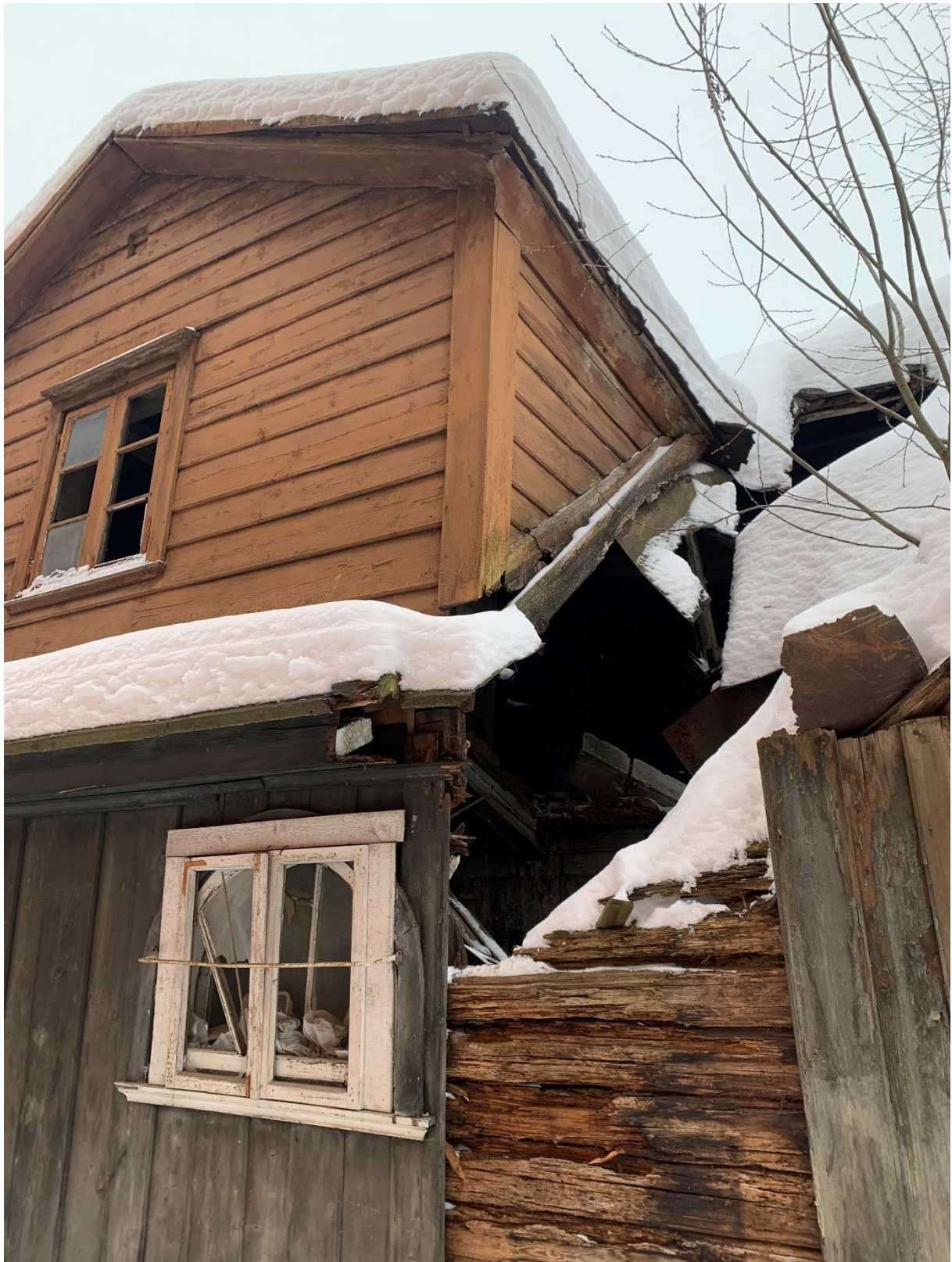
Foto 3. Uus tn 16//18 vana ja lagunenenud elamu vintskapi juurest täiesti lagunenenud, puudub katus, vintskap viltu vajunud.
